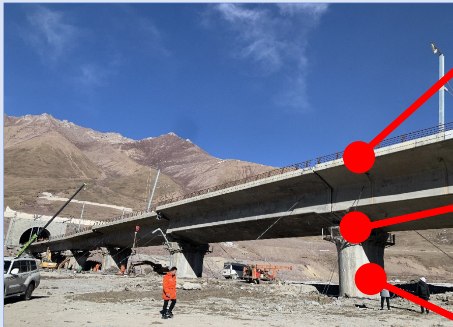
地震下桥梁 - 轨道系统损伤
