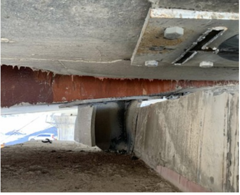
防落梁挡块破坏
