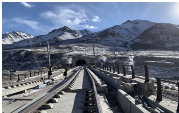
轨道结构损伤
