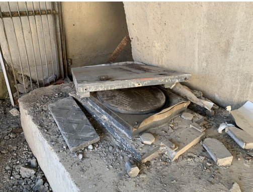
桥梁支座破坏
